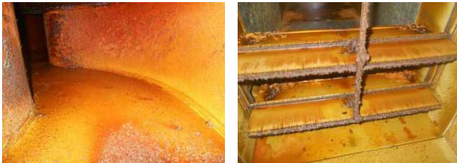
写真4 ダクト内油脂付着状況（右：ダンパー部分）
