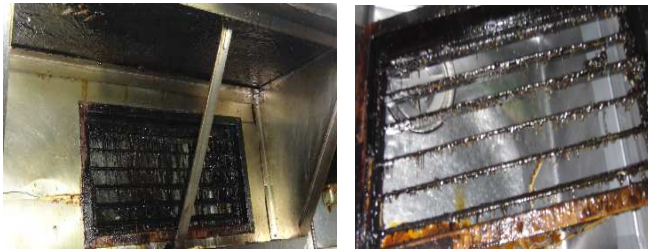
写真3 一般的なグリスフィルターの油脂付着状況
